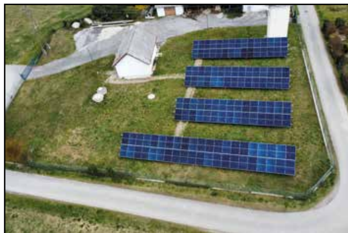
PV-Anlage Brunnen II
